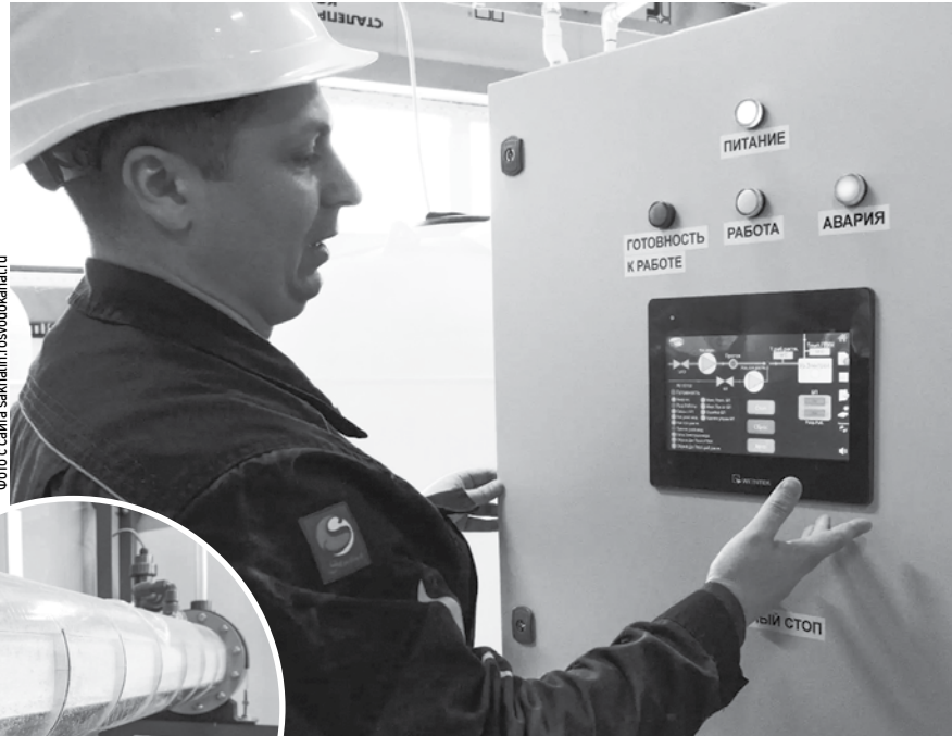
► Электролизное оборудование необходимо для обеззараживания воды на водозаборе «Южный»
